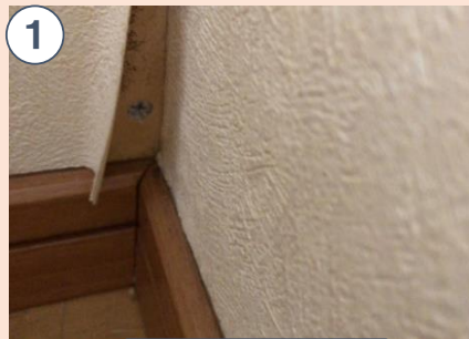
クロス壁の剥げ
