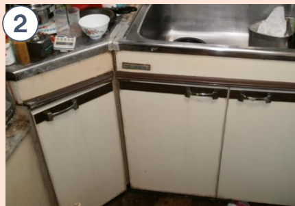
扉面材の劣化
