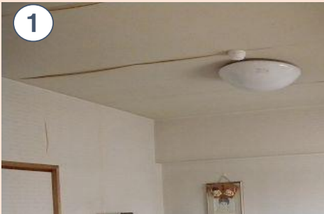
クロスの隙間・汚れ
