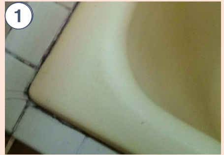
コーキング劣化
