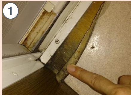
クッションフロアの劣化・剥げ
