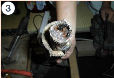
湯の出が悪い（配管詰まり）
