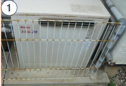
本体外装の腐食
