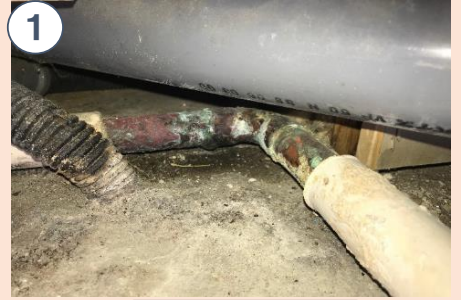
配管・保温材の腐食
