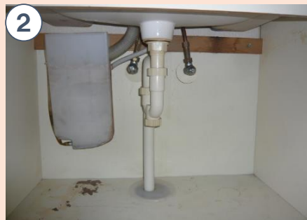
化粧台底板の腐食
