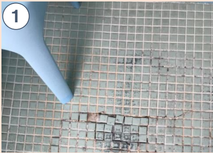
床タイルの剥げ
