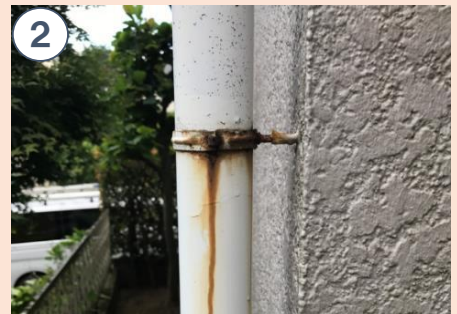
雨樋金具の腐食
