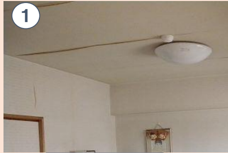
クロス壁の隙間
