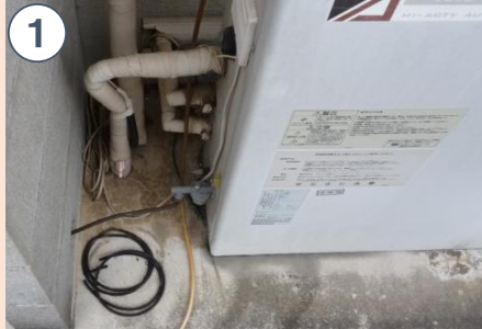
本体からの漏水
