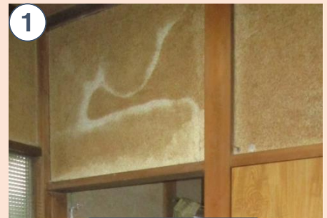
塗り壁の劣化・剥げ
