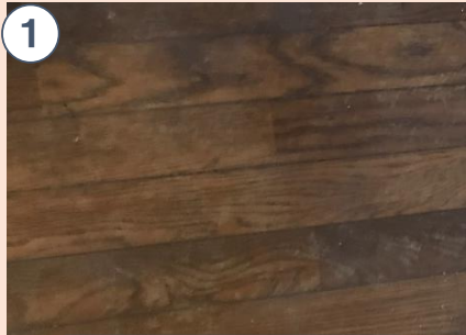
フローリングの劣化・変色
