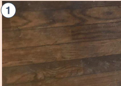
フローリングの劣化・変色
